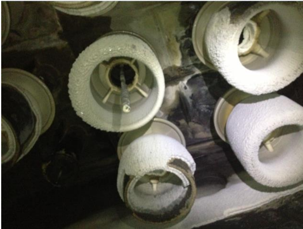
Kuva 6. Puretun kaskadipesurin kipsin tukkimia kaskadiputkia.
